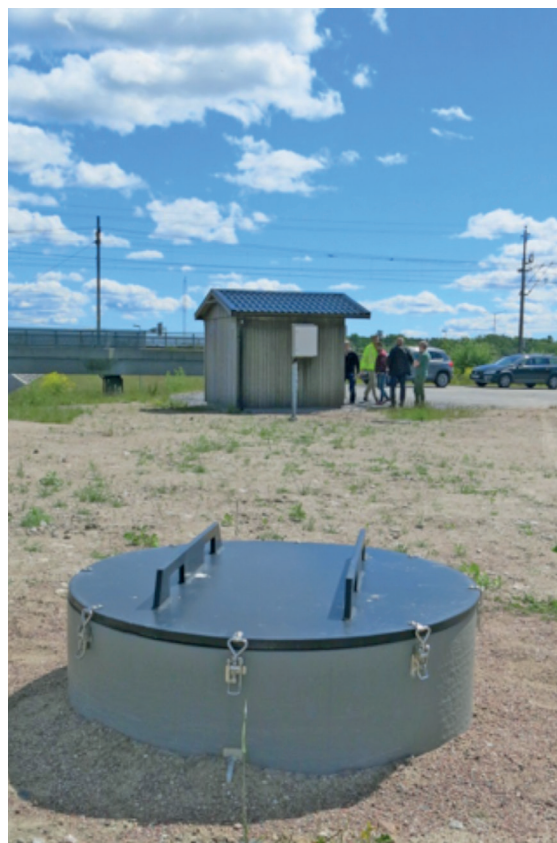
Flygt Odomin och pumpstationen i Rosersberg.
