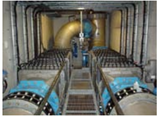
Detail: Installation Stockholm Vatten, water works Lovö I
