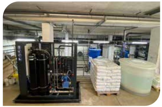
Installierte OSEC B-Pak-Anlage
