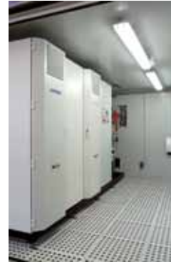
Ozonanlage in einem Container Typ SMO
