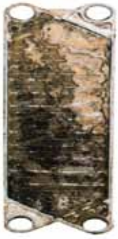
Wärmetauscher bei Einsatz von Bioziden
