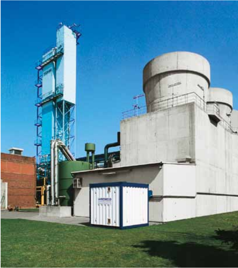
Kompakte Containeranlage zur Ozon-Behandlung von Kühlwasser für eine Luftzerlegungsanlage
