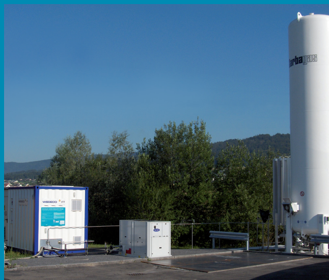
Instalación de ozono de WEDECO en la estación depuradora de aguas de residuales (EDAR) de Wueri, en Regensdorf, Suiza.
