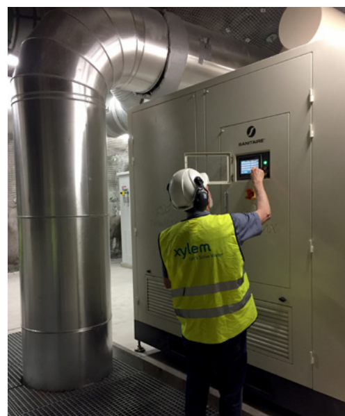
Employé de Xylem assistant au démarrage d'un compresseur MAX600 (400 kW).
