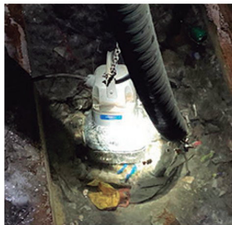
Bomba instalada y en funcionamiento
