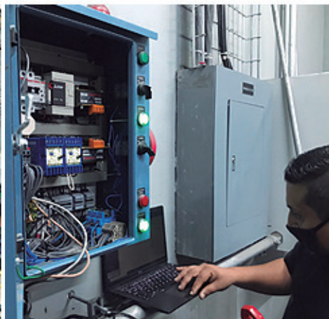
Programación en el lugar a modo de operación nivel.
