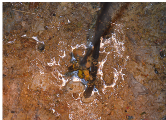
Ennen Flygt Concertorin asentamista Hallunda Gårdsväg 106 A:lla oli vakavia rasva- ja öljykertymiin liittyviä ongelmia.
