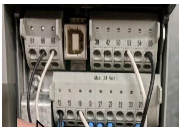
Figura 5.4.9: Cableado del sensor
